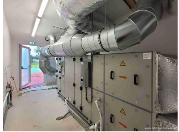
High-efficiency dual-flow mechanical ventilation system Ventilation Mécanique Contrôlée double flux à haut rendement
